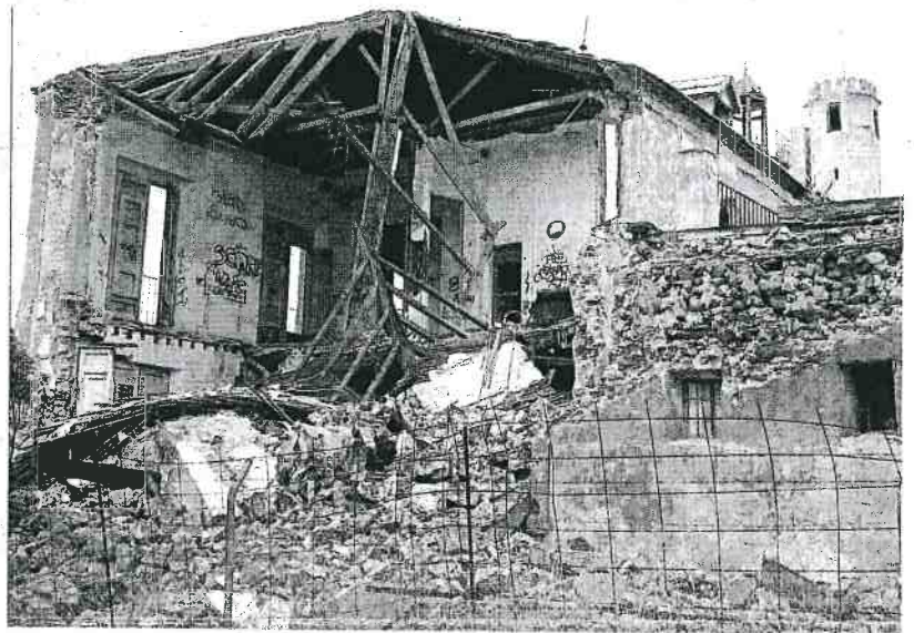
DERRUMBADA. Estado en el que ha quedado la casa de Los Balcones tras la caída. / L. V.
